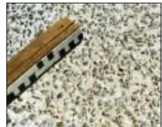
Voorbeeld van uitgewassen beton
