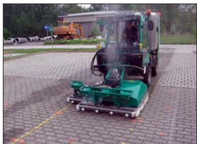
Eau chaude dirigée par capteurs (capteurs de fluorescence)
